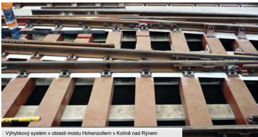
Speciální uložení FFU syntetického pražce na otevřené ocelové konstrukci
