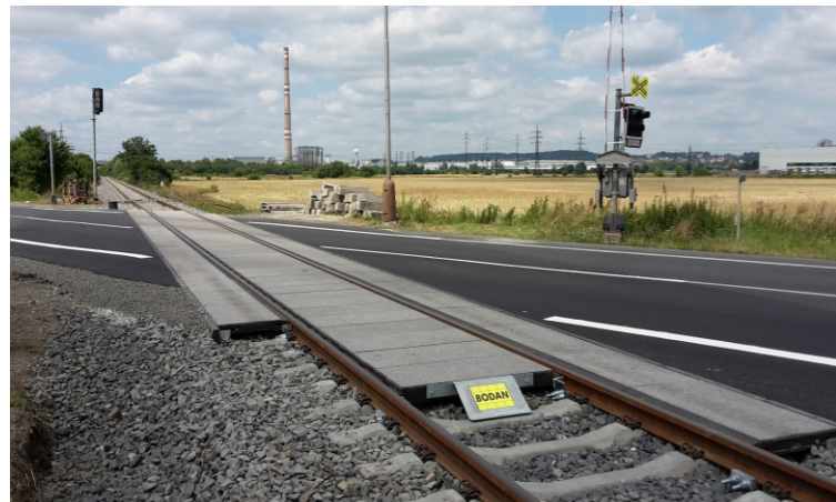
Přejezdová konstrukce BODAN v Řepové u Mladé Boleslavi
