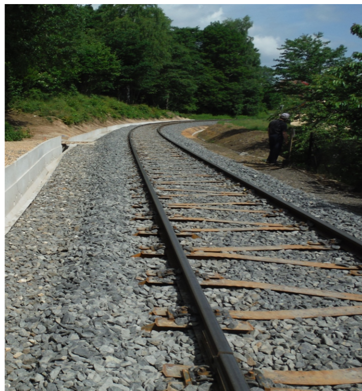
Ocelové pražce Y na trati Liberec – Tanvald
